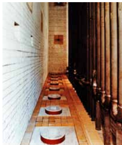
Binnenkant van een ethyleenkraker met branders en doorvoeringen
